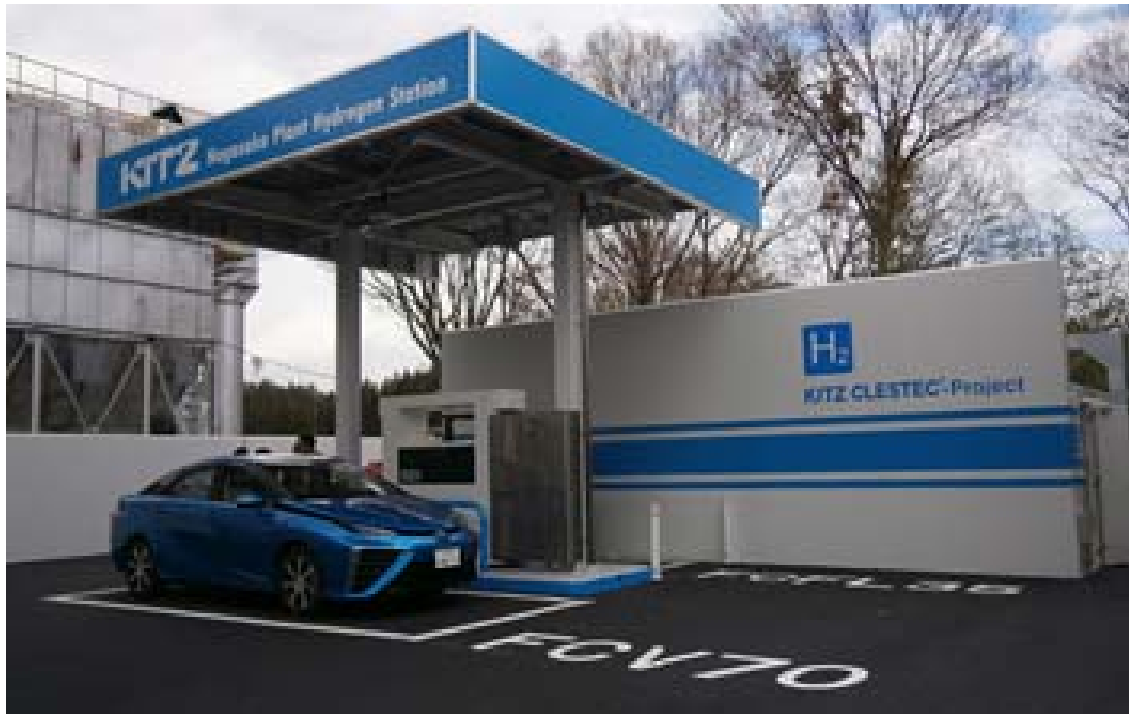
【キッツ長坂工場 水素ステーション全景】
