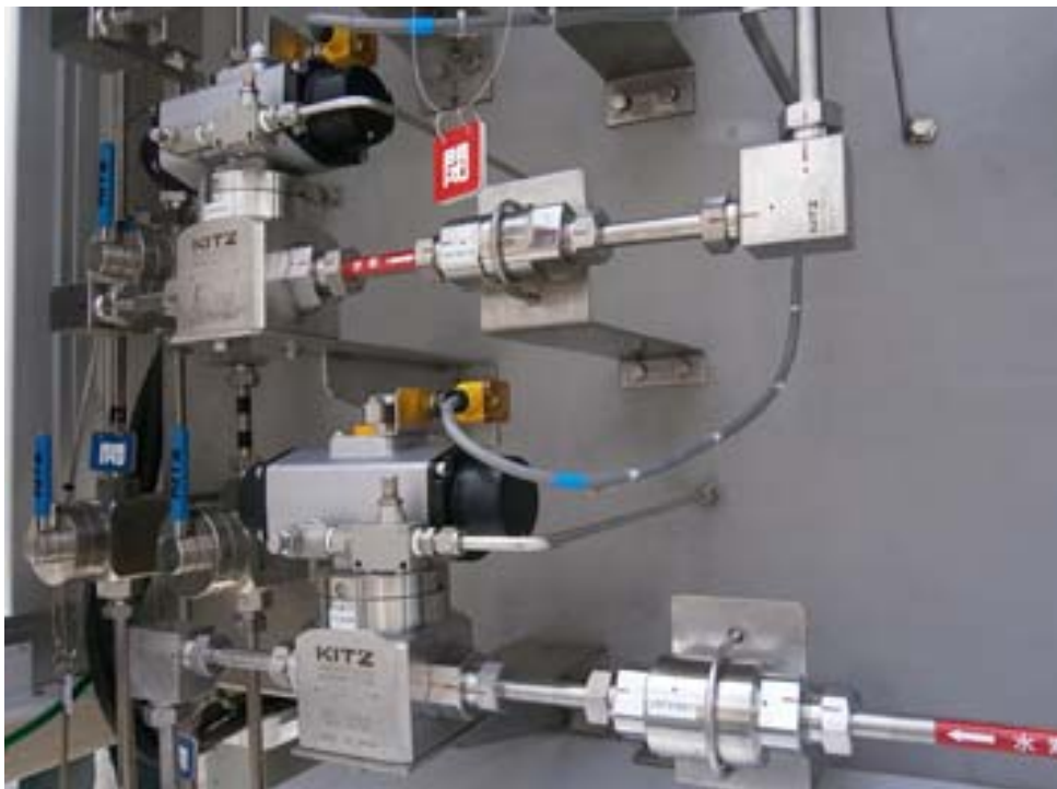
【設置された水素ステーション用バルブ】
