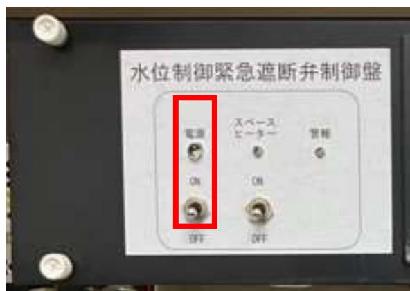
図1電源スイッチ写真
