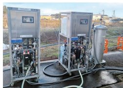
アクアレスキュー設置状況
