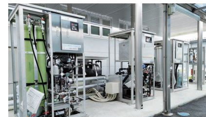
地下水処理装置
