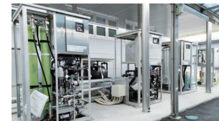
地下水処理装置
